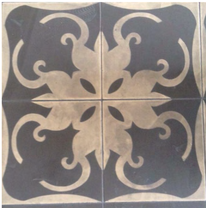
Zementfliesen nicht gut verfugt und gereinigt
